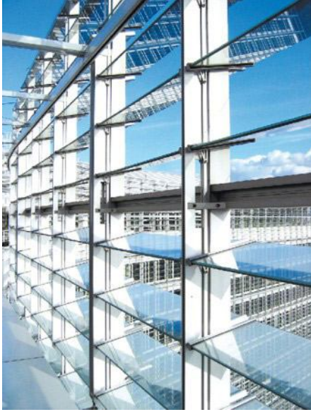
Figure I.63 : Bâtiment Berlaymont équipé de Double facade composée de lamelles de verre mobiles ( Source : http://www.coltinfo.lu )
