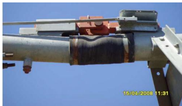
Figure I.7: Élément de liaison entre travée, Photo IRRAGRIS.
