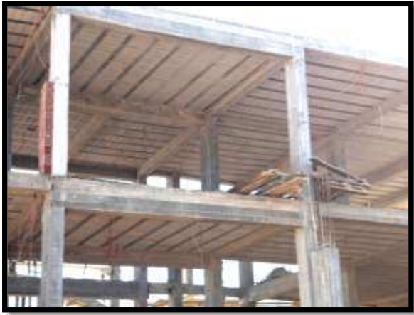
Figure IV.79 : structure en béton armé système poteau /poutre avec dalle en corps creux. Source : auteur
