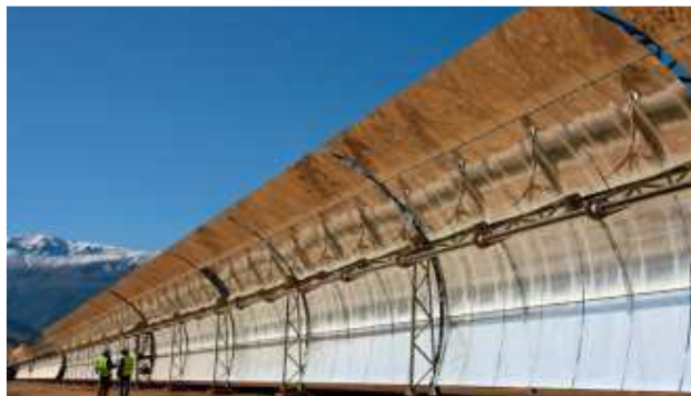
Figure III.55 : Miroirs cylindro-paraboliques d'Andasol, Espagne Source : http://www.connaissancedesenergies.org/sites/default/files/centrale_andasol_en_espagne.jpg
