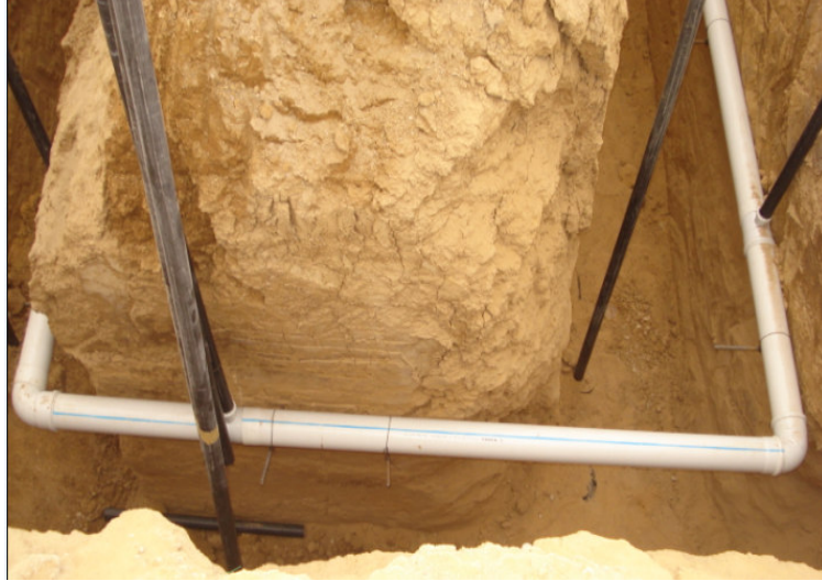
Figure II.3. Image de l'échangeur de chaleur horizontal à différentes profondeurs.
