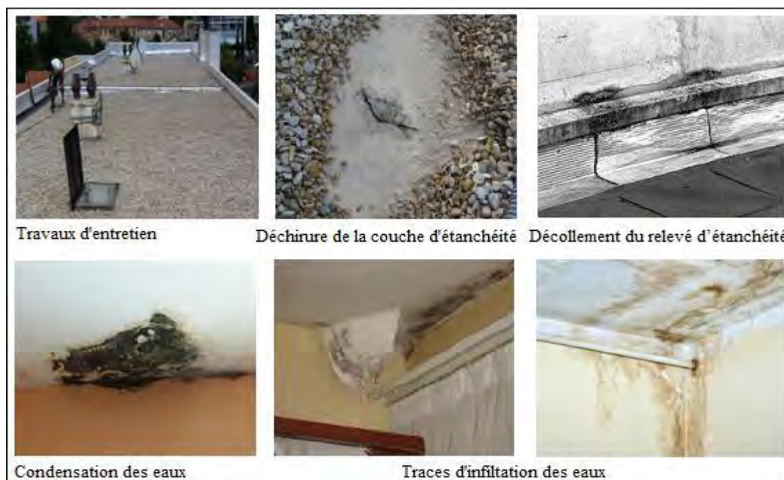
Photos V.5 : Les différentes pathologies dues à la dégradation de l'étanchéité. Source : Entreprise ID Haut, http://www.travaux-en-hauteur.net , Consulté le 25.07.2016 ; CSTB, www.cstb.fr , Consulté le 25.07.2016.
