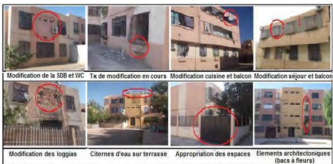
Fig. X.10 : Les déformations et dégradations observées.
