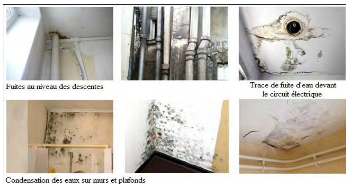
Photos V.4 : Désordres dus aux fuites et condensation des eaux dans les pièces humides.
