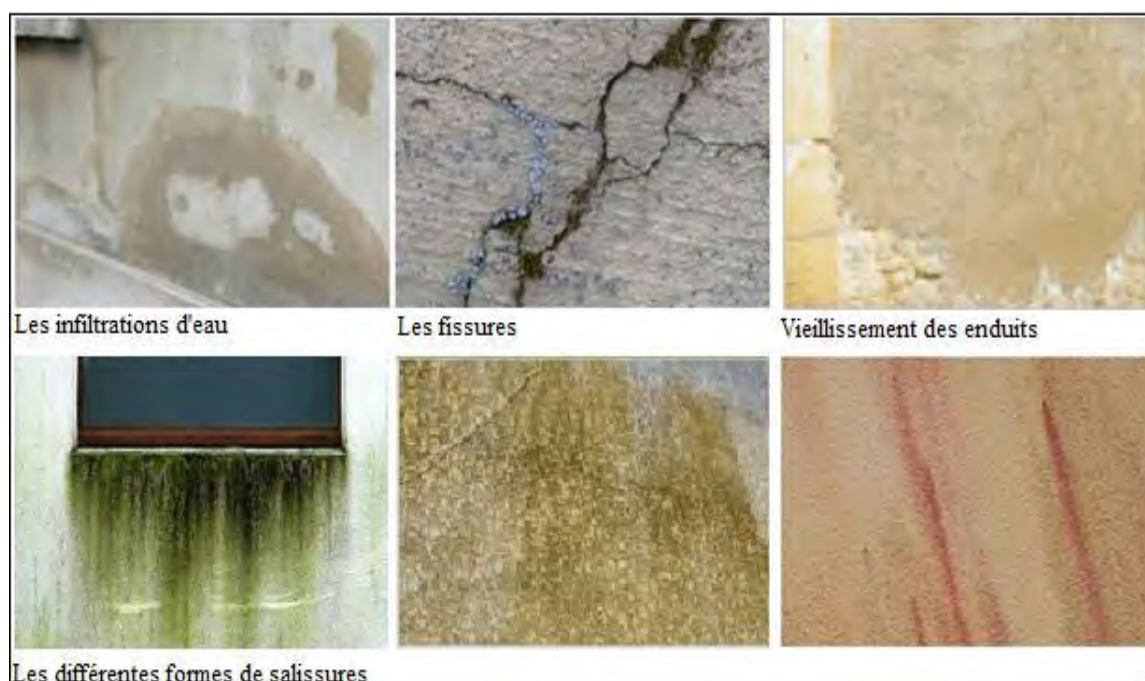
Photos V.1 : Formes de salissures de façades. Source : Dessirier, 2006.
