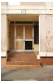
Photo II.6 : dégradations avant réhabilitation
