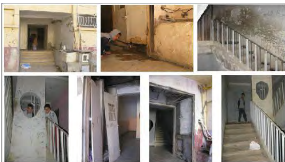
Photos. XI.2 : État dégradé de la cage d'escalier d'immeuble, copropriété 1000 logements. Source : Auteur, clichés 2016.
