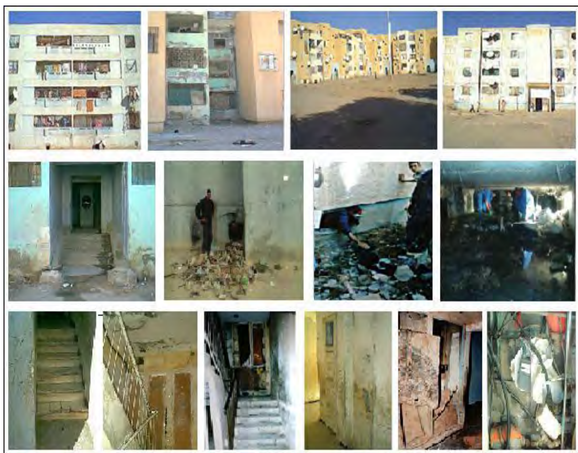
Photos. XI.9 : État dégradé des cités en copropriété à M'sila. Source : Auteur, 2017, clichés, 2003.
