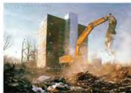
Photo II.2 : Destruction des logements locatifs. Source : Rousseau, 2004.
