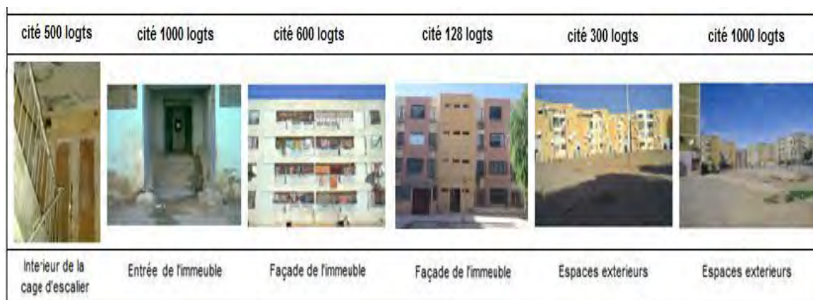
Fig. II.6 :  tat d grad  des logements sociaux transform s en copropri t s. Source : Auteur, 2017.
