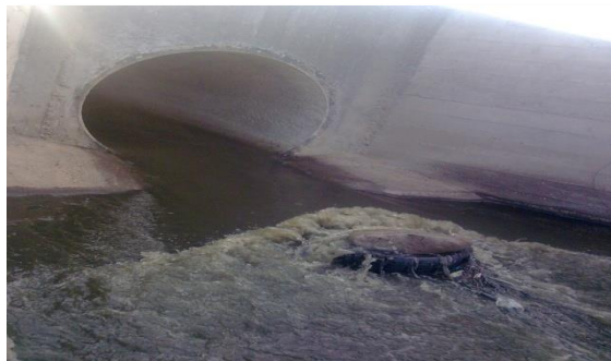
Figure .2.7. Site de rejet Biskra
