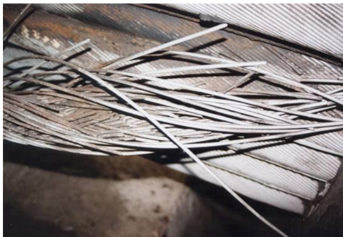
Figure 3.18 : Rupture d'un toron attribuée à la combinaison de phénomènes de corrosion fissurante et de fatigue (en flexion) [BRE05].
