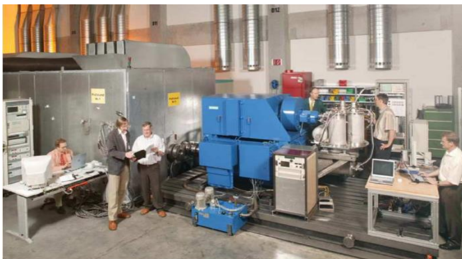
Figure II.4. Alternateur 4MVA Siemens en plateforme d'essai [Siemens Workshop 2000].
