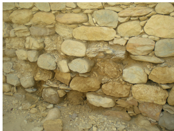
Photo 26 : Traces d'humidité par remontée capillaire
