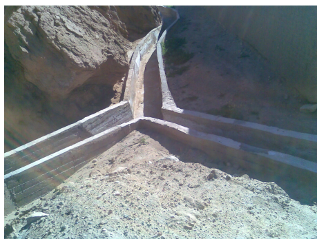
Photo 15 : Les digues en béton armé pour la canalisation des eaux de ruissellement
