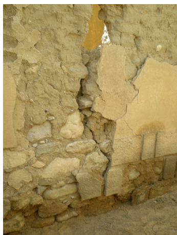
Photo 25: Fissure par mouvement du terrain
