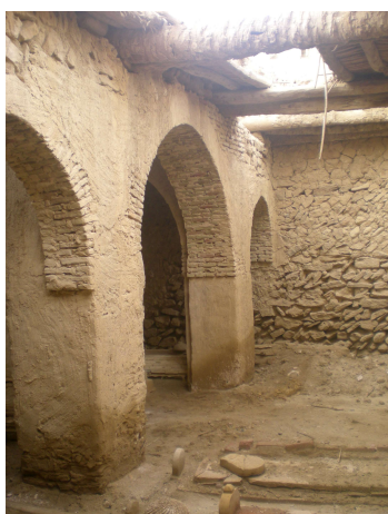
Photo 17 : L'état de dégradation de la toiture du cimetière (avant restauration)
