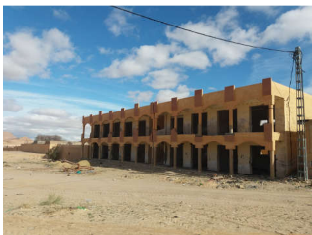
Photo V-5 : Les locaux du programme étatique abandonnés et dégradés (Source : Auteur, 2020)
