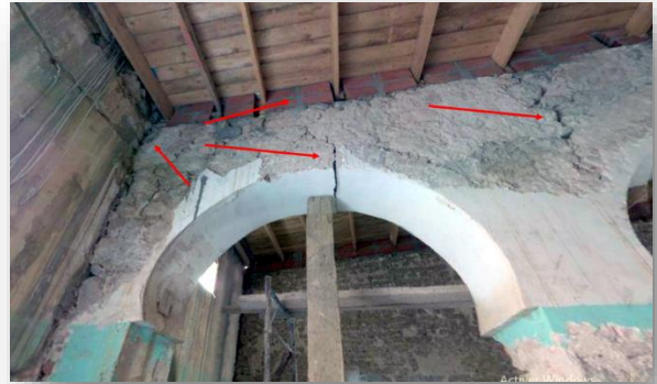
Photo n°154 : Triples fissures sur l'arc causé par l'élément lui-même et le nouveau plancher. Source : Auteure.2022.
