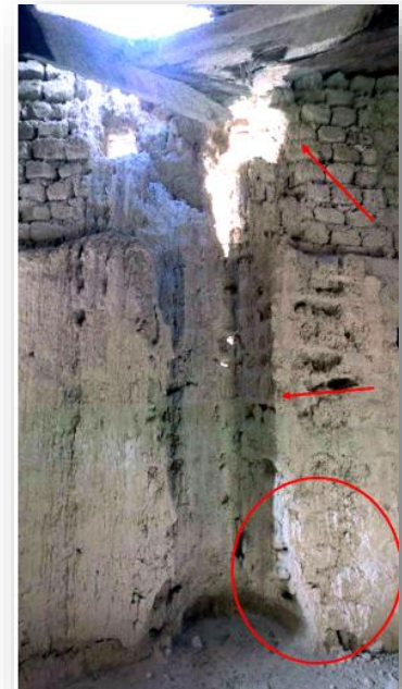
Photo n°137 : Conséquences de l'infiltration d'eau de pluie sur le mur dans la maison 18. Source : Auteure.2022.
