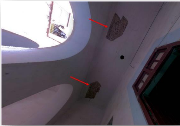
Photo n°147 : Dégradation de l'enduit du plafond sous l'effet de l'infiltration de l'eau. Source : Aueture.2022.
