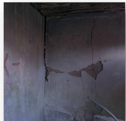
Photo n°120 : Fissures d'angle et du milieu du mur causé par un tassement différentiel des fondations. Auteure :2022.
