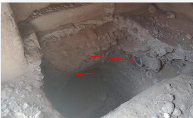
Photo n°181 : canalisation d'assainissement reliée à une fosse septique. Source : Auteure :2022.
