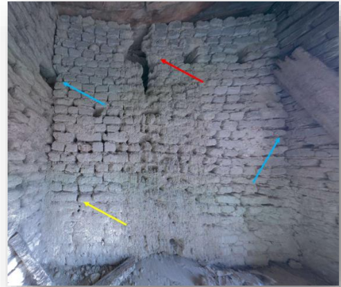
Photo n° 142 : Fissures causés par plusieurs pathologies structurelles à la fois. Source : Auteure.2022.
