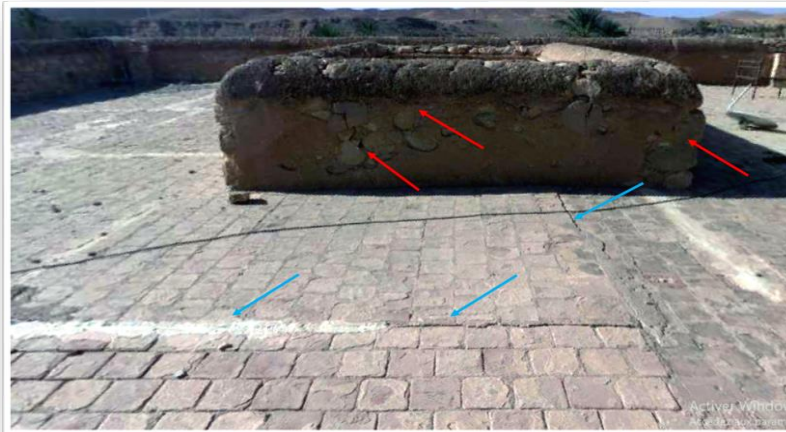
Photo n°150 : Désordres au niveau de l'acrotère et le plancher de la terrasse dans la maison Ben Hassine . Source : Auteure.2022.
