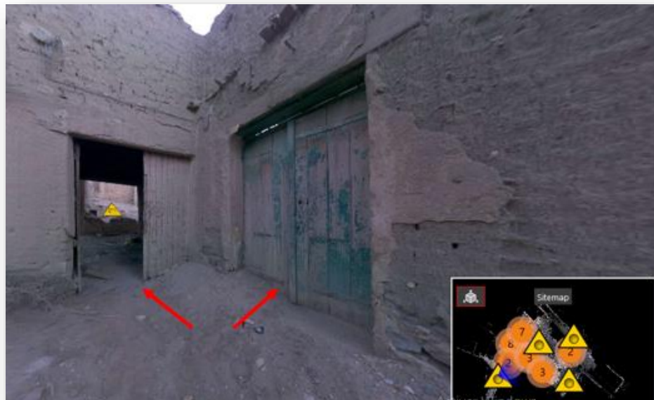
Photo n°178 : photo JetStream sur l'entrée du caravansérail indiquant l'altération des portes et nécessité de réparation. Source : Auteure.2022.
