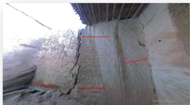
Photo n°135 : Désordres causés par l'action des surcharges, humidité et vent. Source : Auteure.2022.
