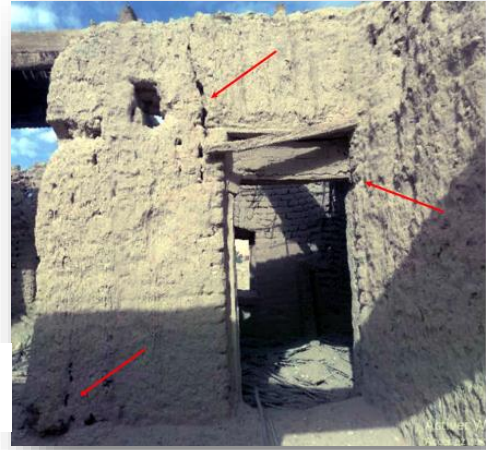
Photo n°144 : L'action du tassement différentiel et le vent sur le mur d'une chambre à l'étage. Source : Auteure.2022.
