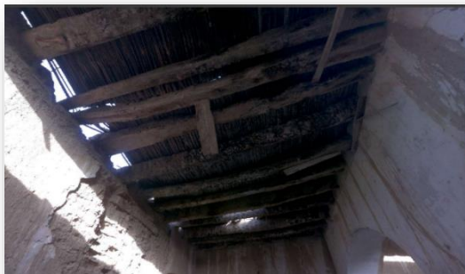
Photo n°123 : Délabrement de la toiture et fragilité des deux côtés de l'appui . Source : Auteure.2022.
