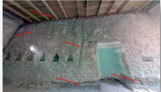
Photo n°153 : Aggravation de fissures au milieu et à l'angle du mur causé par la surcharge du nouveau plancher. Source : Auteure.2022.
