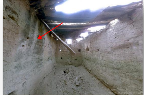
Photo n°129 : Dommages causés par les eaux de ruissellement, infiltration, condensation intérieure et le vent. Source : Auteure.2022.
