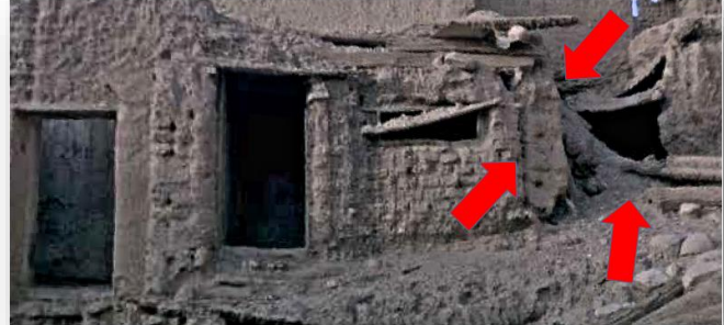
Photo n° 119 : Vue sur de l'extérieur de la fissure d'angle de la cage d'escalier et effondrement du reste de l'étage source : Auteure.2022.
