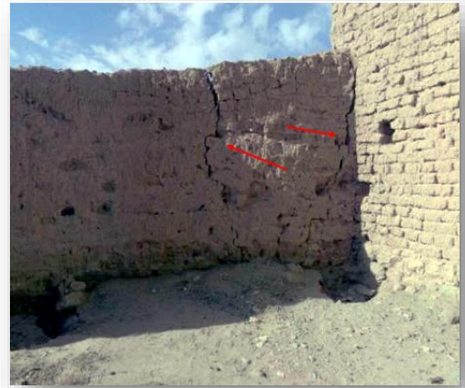
Photo n°140 : Fissures engendrées par un tassement différentiel des fondations et hétérogénéité dans les charges. Source : Auteure.2022.
