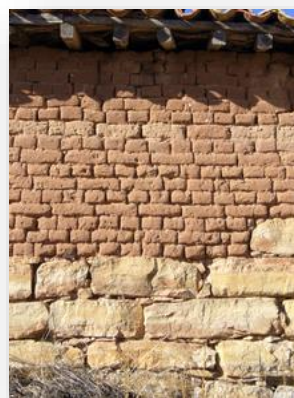
Photo n° 55 : Mur en adobe sur soubassement en pierre dans une maison antique de Burgos, Espagne. Source : Wikipédia. 2008. consulté le 11/11/2018.
