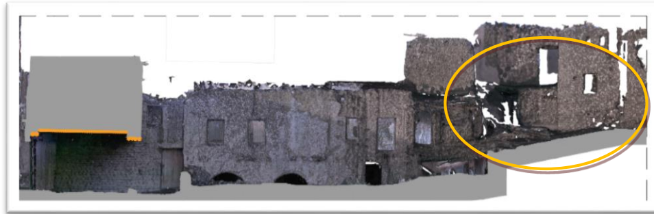
Fig. n°115 : Façade 3d texturée intérieure Sud dont une partie est en ruine. Source : Auteure.2022.
