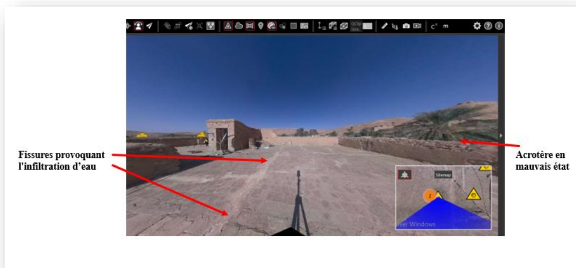
Photo n° 176 : Photo JetStressm sur la toiture terrasse de la maison Ben Hassine montrant la dégradation du plancher et l'altération de l'acrotère. Source : Auteure.2022.
