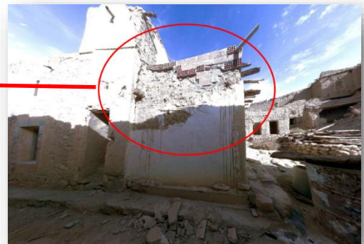
Photo n° 155 : Déformation de la façade à cause de l'intervention inadéquate. Source : Auteure.2022.
