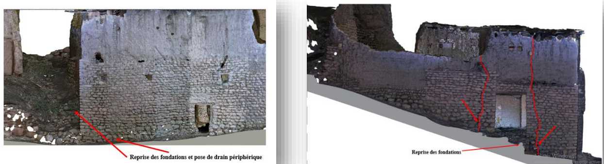
Fig. n°169 : Photo 3D texturée de la façade Nord de la maison 10 indiquant l'emplacement de la reprise des fondations. Source : Auteure .2022.
