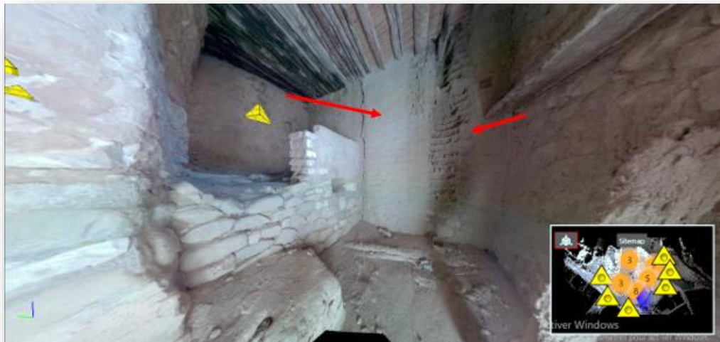
Photo. N°170 : Photo JetStream sur la maison 10 montrant déformation du mur provoqué par le phénomène d'érosion. Nécessité de remplacement de brique. Source : Auteur.2022.
