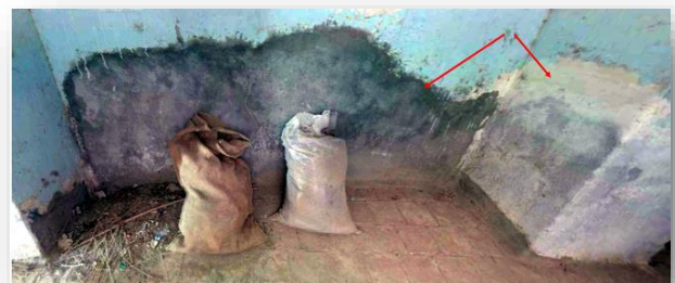
Photo n°146 : Reprise du bas du mur avec du ciment pour pallier aux effets de la remontée capillaire. Source : Auteure.2022.
