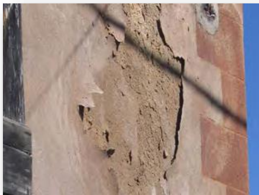
Photo n° 57 : Enduit à la chaux détérioré et décollé. Source : CAUE de l'Ariège, CAUE des Hautes-Pyrénées -, 2011.
