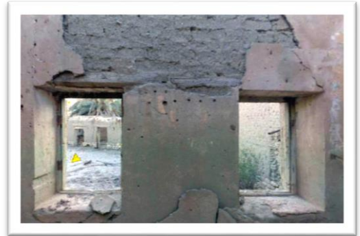
Photo n°121 : Le linteau déformé en bois provoque la décompression d'une partie du mur, ce qui a entraîné la formation de fissures suivant un arc de décharge. Auteure :2022.
