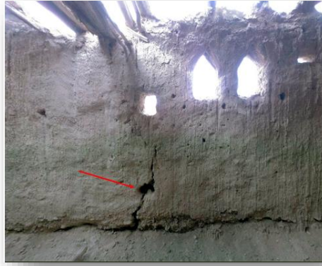
Photo n°133 : Fissure de poinçonnement causée par une mauvaise répartition des charges sur le mur. Source : Auteure.2022.
