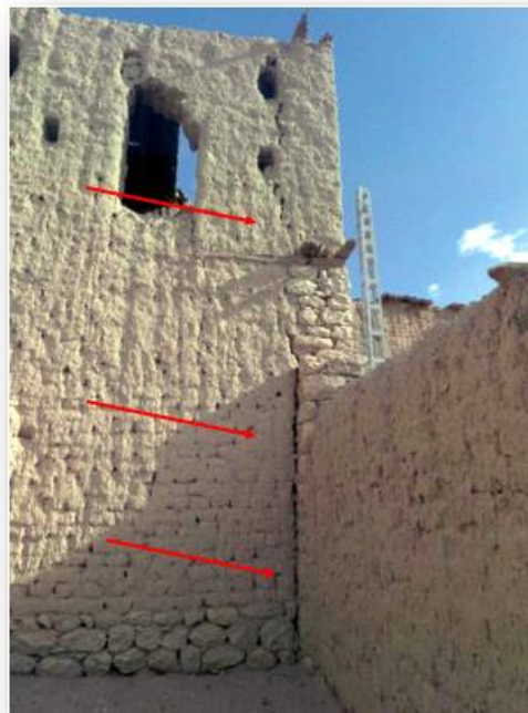
Photo n°141 : Fissures sur la façade Sud intérieure générées par un tassement différentiel des fondations. Source : Auteure.2022.
