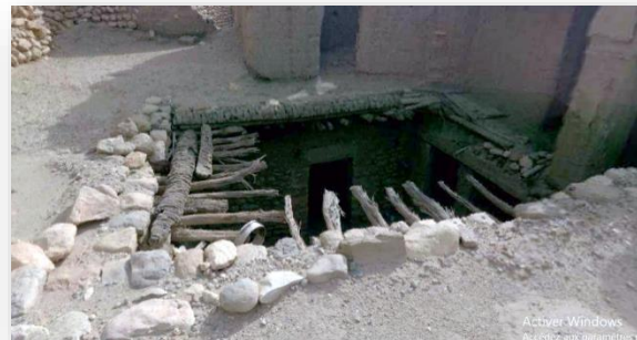
Photo n°130 : Désintégration des éléments qui constituent la toiture à cause de l'érosion de tête. Source : Auteure.2022.
