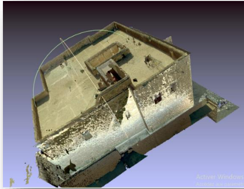
Fig. n°136 : Erosion de tête visible le long du mur sur la façade Nord. Image 3D Mesh Lab. Source : Auteure.2022.
