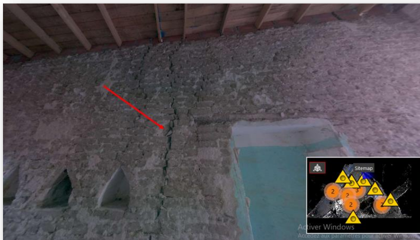
Photo n° 175 : Photo JetStream montrant une fissure de poinçonnement causé par la pose du nouveau plancher inapproprié nécessitant une clef. Source : Auteure.2022.
