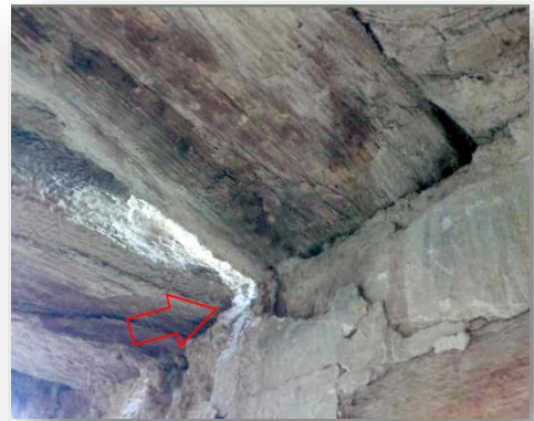
Photo n°116 : Détérioration du bois de la toiture et altération de l'appui poutre/ mur à cause de l'humidité. Source.Auteure.2022.
