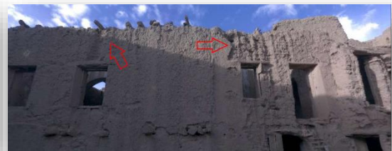
Photo n°112 : Façade Sud du caravansérail dont le mur est très altéré par l'érosion de tête. Source : Auteure.2022
