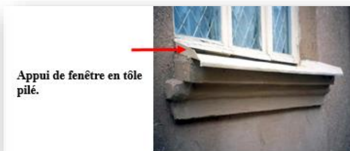
Photo. N° 180 : Plaque de tôle pilé pour l'étanchéité de l'appui de fenêtre. Source : S. Moriset.2011.
