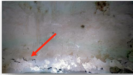
Photo n°126 Dégradations du bas du mur causé par l’efflorescence avec détachement de l’enduit de revêtement. Source : Auteure.2022.
