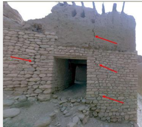
Photo n° 134 : Tassement différentiel des fondations dû à l'inclinaison du terrain et les charges supplémentaires. Source : Auteure.2022.
