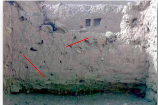
Photo n°136 : Déchaussement du mur et érosion de tête au niveau de la Zriba et la cour. (Maison 18). Auteure.2022.
