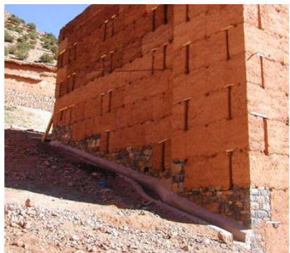
Photo n° 162 : Exemple de drain extérieur sur un terrain en pente. Source : S. Moriset.2011.
