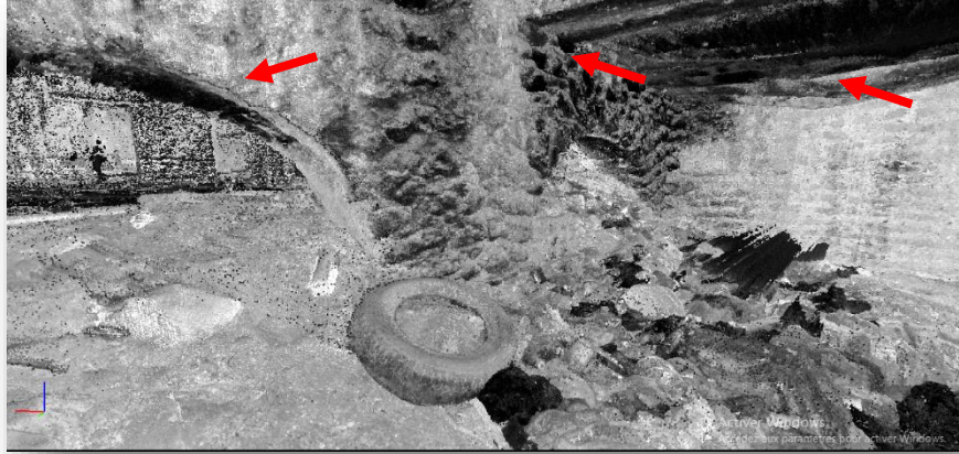
Photo n°108 : Vue jetstream traitée, les zones noires révèlent le développement de moisissures et champignons dans les locaux de commerces au rez-de-chaussée du caravansérail. Source : Auteure.2022.
