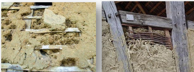
Photo N° 65 : Torchis : quelques pathologies structurelles. Source : J. Lamoureux.2007
