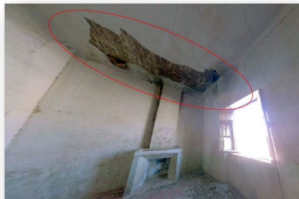
Photo n°148 : Détérioration du revêtement du plafond à cause d'une infiltration d'eau de pluie. Source : Auteure.2022.
