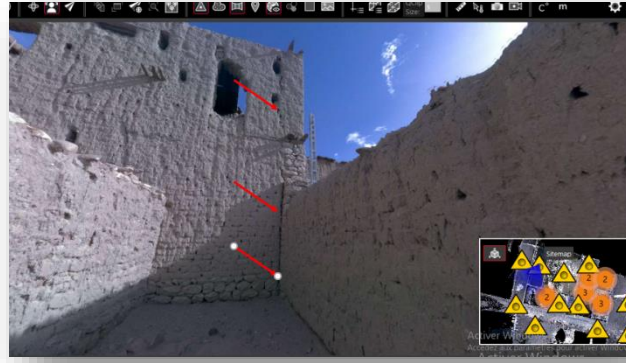
Photo n°168 : Photo JetStream sur la maison 18. Localisation du tassement différentiel nécessitant la reprise des fondations. Source : Auteure.2022.
