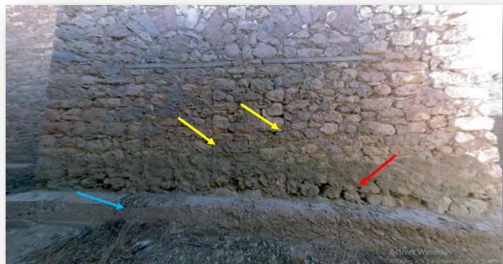
Photo n°149 : Pathologies structurelles sur la façade Nord de la maison Ben Hassine . Source : Auteure.2022.
