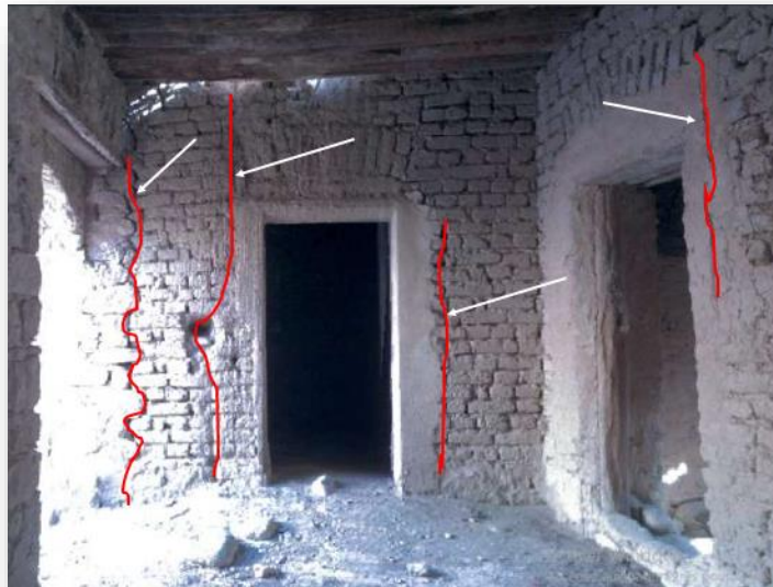
Photo n° 139 : Fissures dues à une différence de rigidité des matériaux et leur réalisation. Source : Auteurs.2022.
