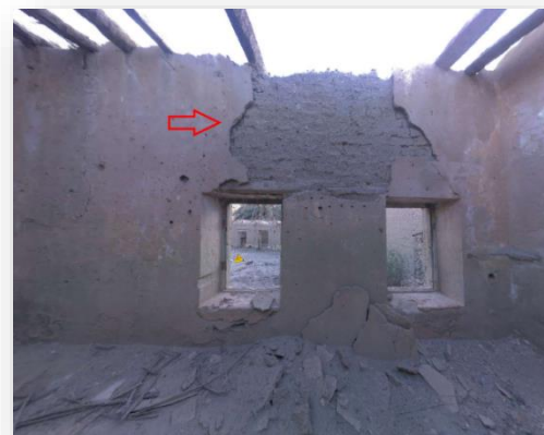
Photo n° 114 : Détachement de l'enduit du a une infiltration d'eau. Source : Auteure.2022.
