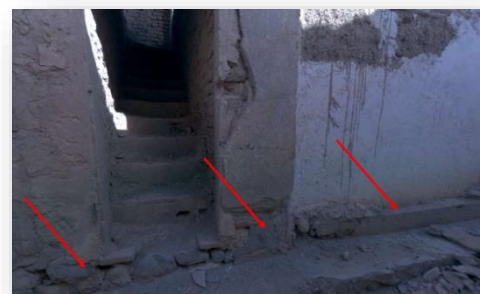
Photo n°152 : Déchaussement du bas du mur. Source : Auteure.2022.
