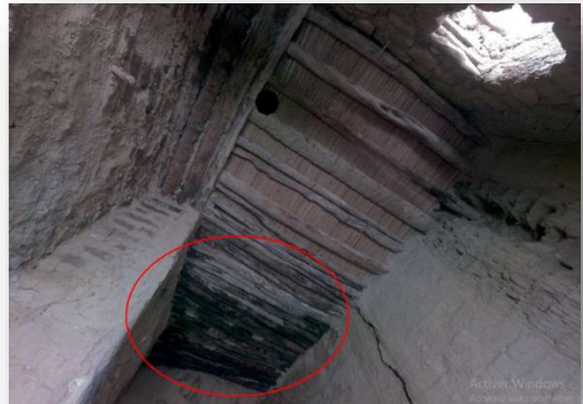
Photo n°128 : Développement de moisissures sur le bois de genévrier causé par une condensation, infiltration et mauvaise aération. Source : Auteure.2022.
