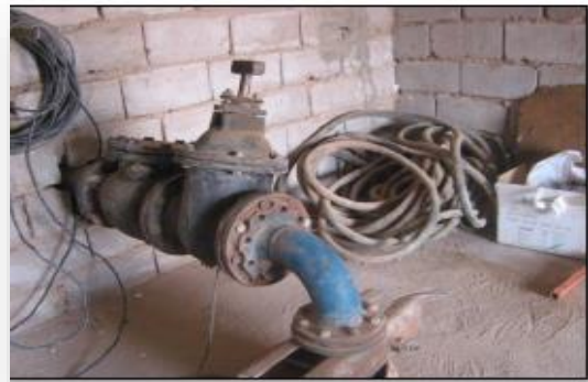
Photo n°24 : Installation de forage motopompe immergé pour l'irrigation. Aougrout , Adrar. 2011 Source : I. Salem, 2011.
