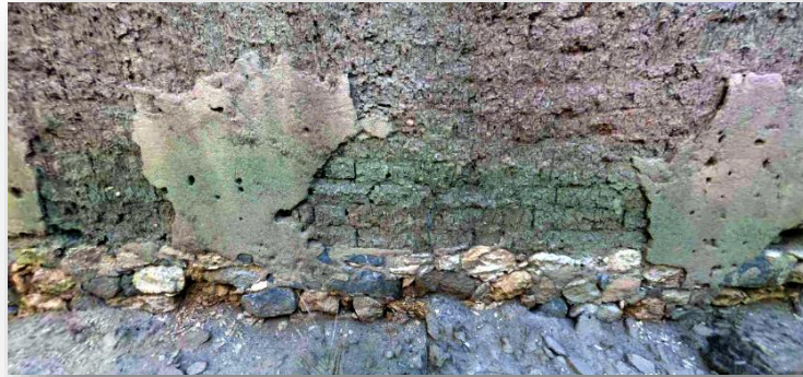
Photo n°110 : Effet de rejaillissement et érosion du bas du mur. Source : Auteure.2022.
