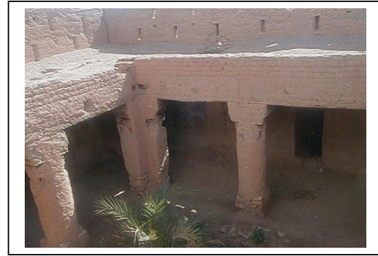
Photo n°19 : La Tahezza (galerie) dans le ksar de Boukaïs dans la wilaya de Béchar. (2005) (Wast Dār d'El Qadi). Source : M.A. Djeradi.2013.
