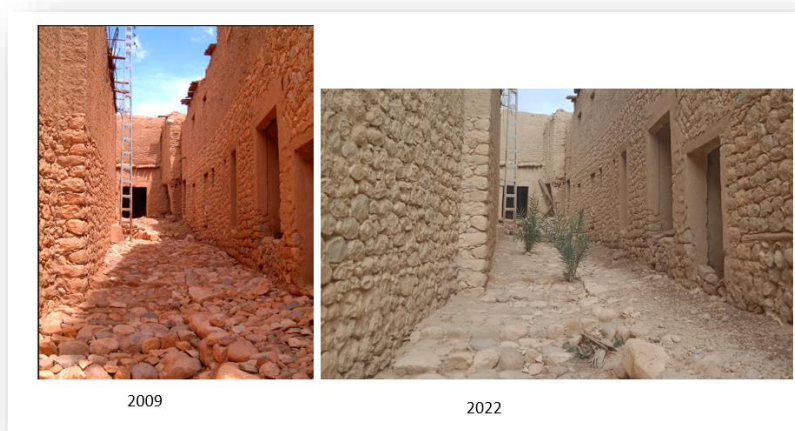
Photo n° 159 : Une ruelle pavée en pierre en 2009, dégradée en 2022 en l'absence d'entretien. Source : Auteure.2022.
