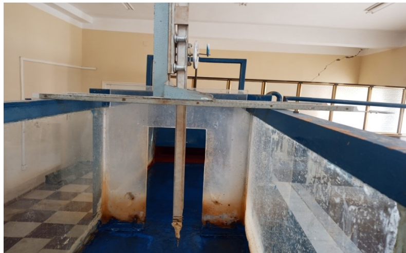
Figure 3.6 : Photo du déversoir rectangulaire
