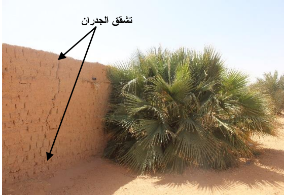
(ب): تشقق جدران مَحْبِسِ الأغانم "أساراف" المبني حديثًا بالطين (2019) بسبب قرب جذور النخيل من أساساته، المسكن العائلي للباحث، قصر بدریان تيميمون
