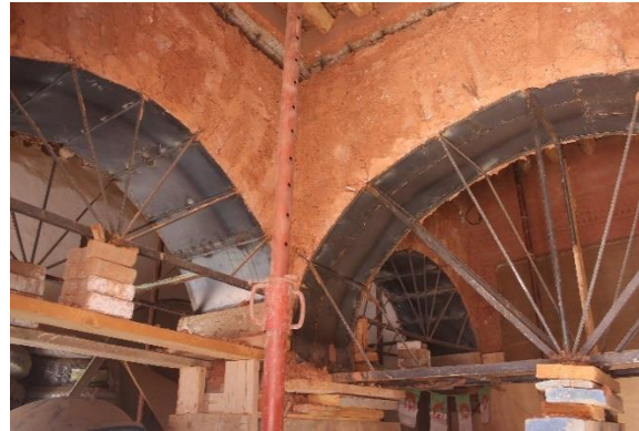
(ج): إتخاذ الإجراءات الخاطئة بمشروع ترميم مقر المركز (CAPTERRE) سنة 2015؛ إعادة بناء الأقواس بطريقة خاطئة، خاصة مع إضافة الروافد الخرسانية المسلحة والمتقاطعة بدون أعمدة (ترميم 1998)
