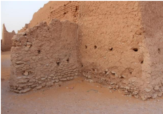
(ح): تضرر المدخل الخارجي للأغمام
