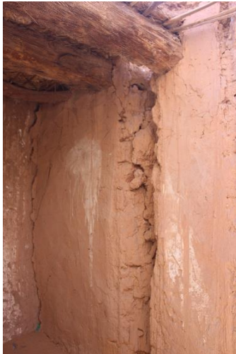
(ب): تسرب مياه الأمطار عبر السقوف، وإحداث شروخات بليغة بالجدران قد تؤدي إلى سقوط جزء من السقف، إيلحيين كالي، أولاد سعيد
