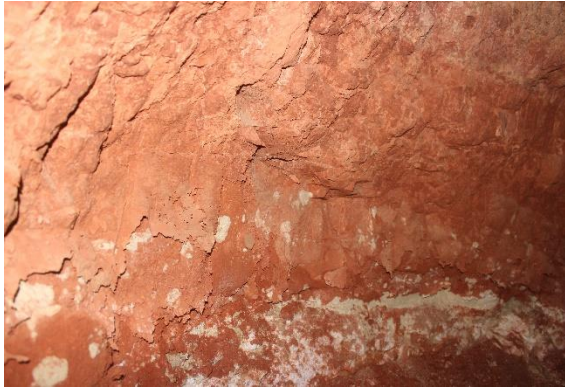
(ب): تلف جدران إحدى المغارات بعد ارتفاع منسوب المياه تحت السطحية، قصر بني يسلم شروين
