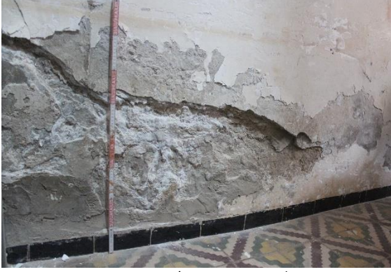
(ب): تبلور الأملاح بشكل كثيف أسفل الجدران بمقر المركز
