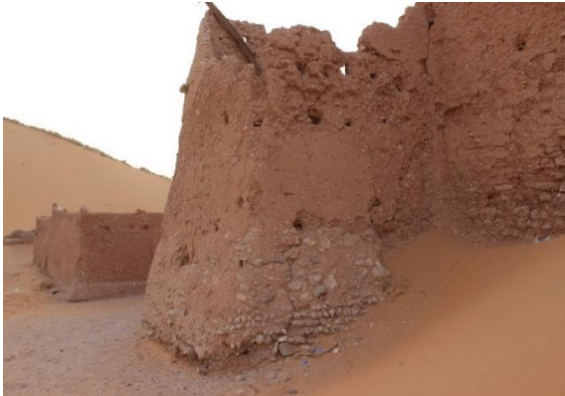
(ث): تآكل وتضرر الأساسات والأسوار وقممها وتساقط أجزاء كبيرة منها، وذلك مع تهالك ملاطها
