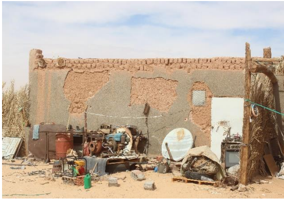
(ث): تشرخ وإنفصال الملاط نتيجة عدم توافق الملاط (إسمنت مع الطوب الطيني)، بلغازي دلدول
